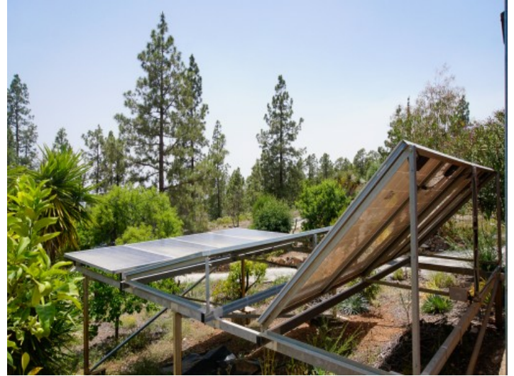
Placas solares grandes
